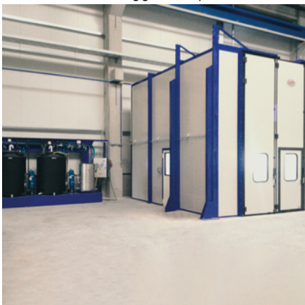
➤ Skid per il recupero dei liquidi a ciclo chiuso
