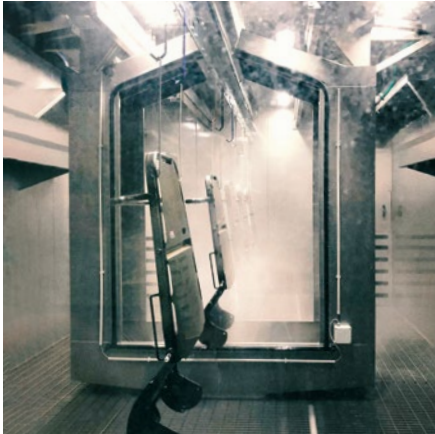
➤ Waschkabinen mit automatischem Waschportal
