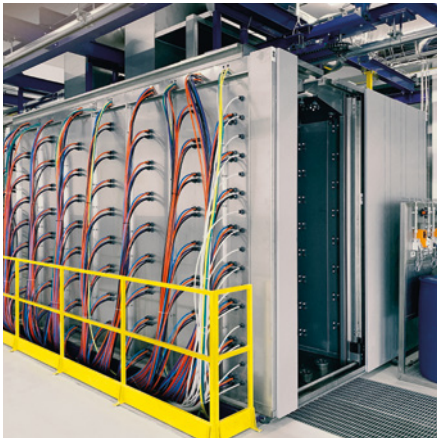
➤ Celle di lavaggio automatiche
