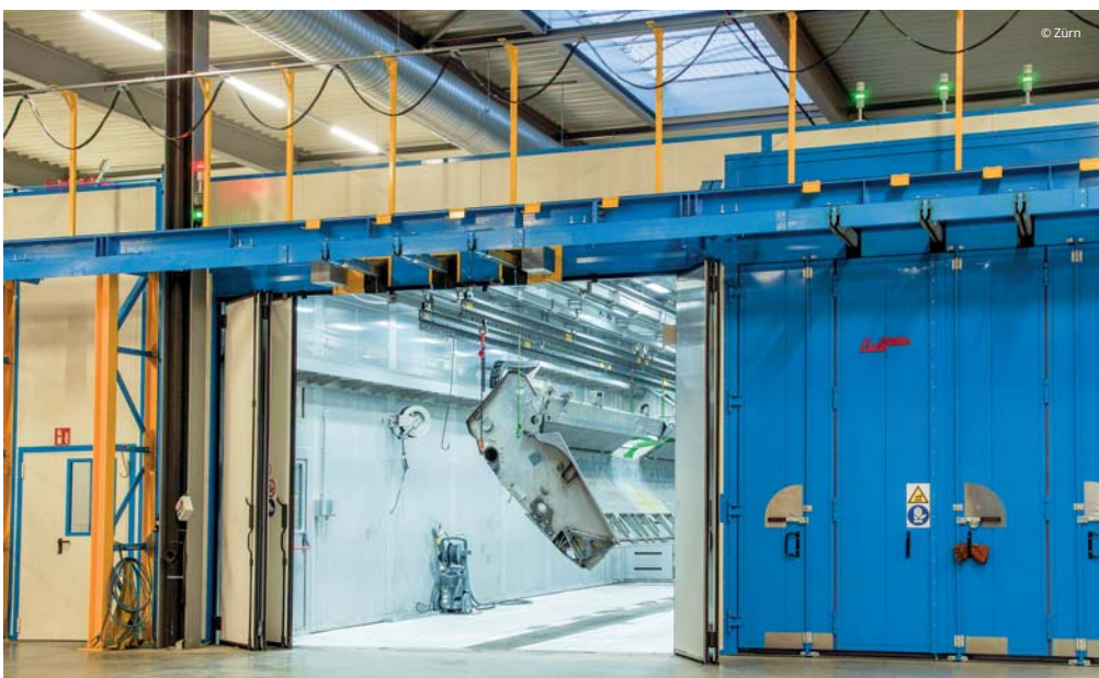
La cabina di lavaggio e il forno di polimerizzazione.
